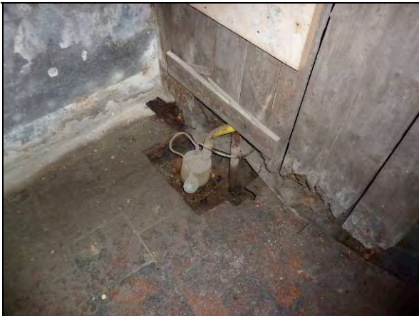
Een dompelpomp is permanent geïnstalleerd om de kelder droog te houden.
