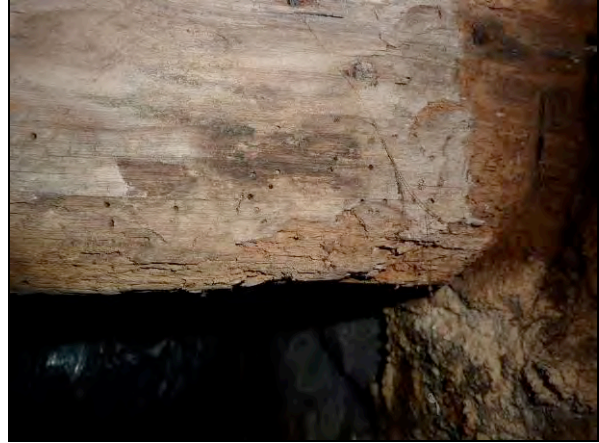
Houtworm in een van de balken.
