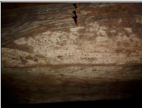
Op diverse plaatsen zijn de balken aangetast en klinken ze hol.
