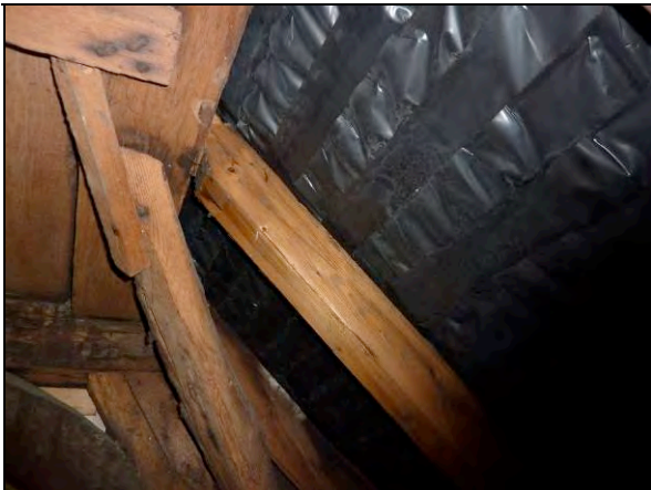
De kap is niet geïsoleerd, er is wel dampremmende folie aangebracht.
