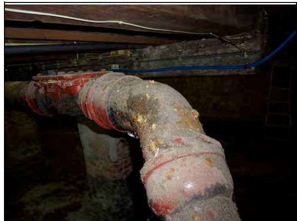
De gietijzeren rioleringsbuis vertoont roestvorming, vervangen door pvc zal noodzakelijk zijn.
