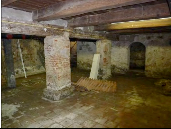
De kelder onder het voorste pand is regelmatig nat.
